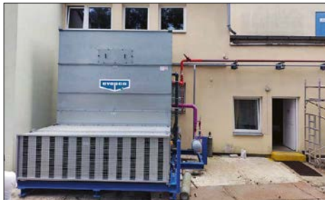
■ Část nové kondenzační stanice chlazení ZS
